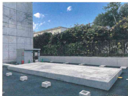
[写真 1] 新しく本館裏に造設された熱源機器置き場の様子。 左は現代美術棟の建物（2021年11月26日撮影）
