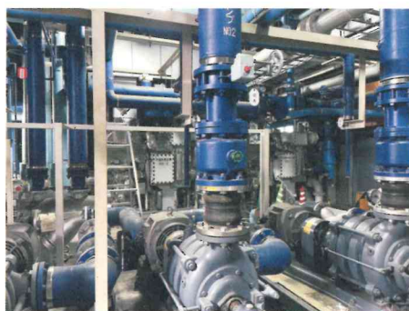
[写真 2] 本館機械室内の様子。奥に見えるのが熱源機器（冷温水発生器）。手前のポンプ類を含め、すべて撤去・新設される（2021年11月23日撮影）
